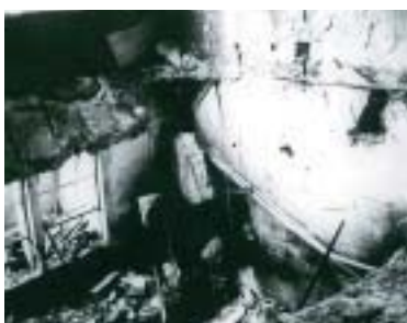
校舎1階中央部床と梁が地下へ落下:E
