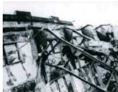
校舎北側4階部分の被害:E
