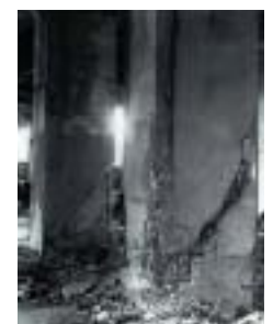
校舎1階内部柱の崩壊:C
