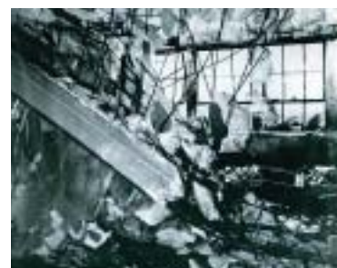
校舎1階の梁と床崩壊:C
